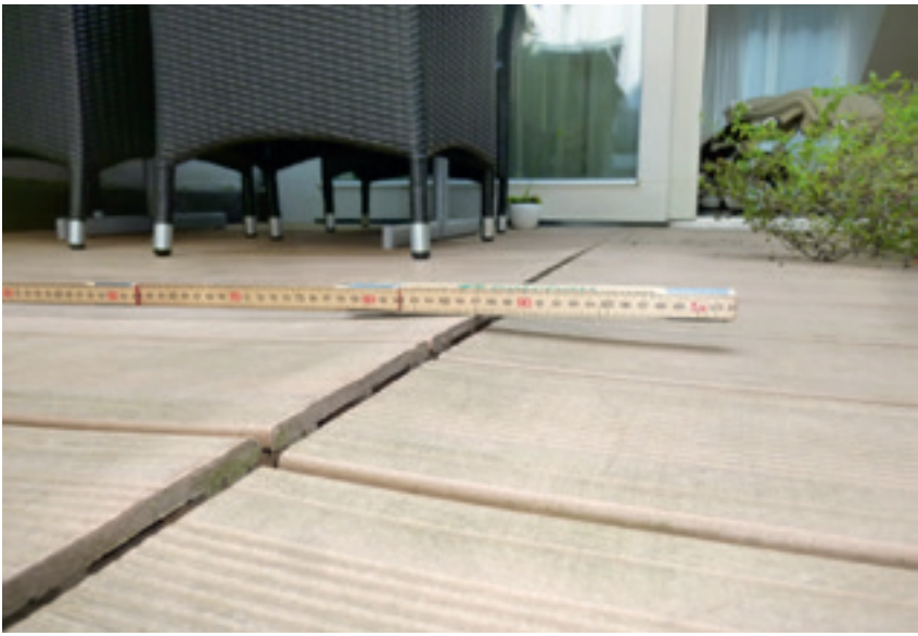
Nicht fachgerecht montiertes WPC-Terrassendeck
